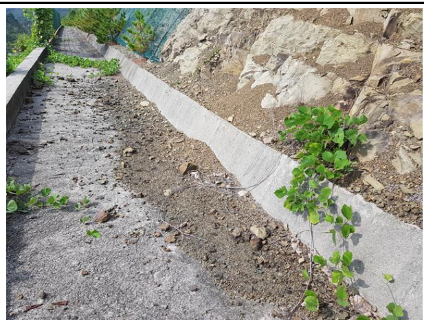
소단배수로 토사 및 낙석적치
